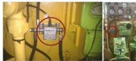
Расходомеры DFM, установленные на судах
